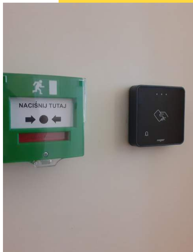
system kontroli dostępu
